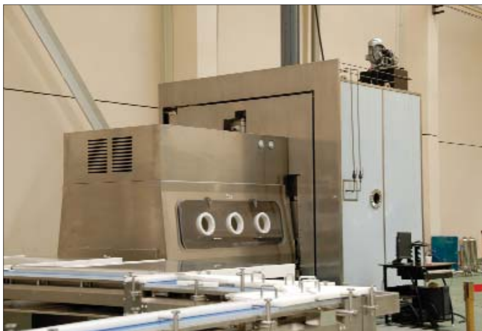
Рис. 14. Леофильная установка с изолятором производства Tofflon
